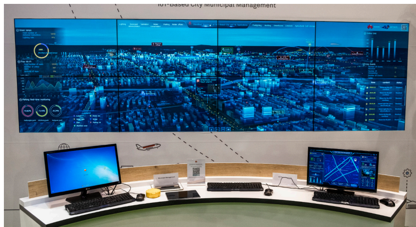
バルセロナで開催されたスマートシティワールドエキスポにて披露された、ファーウェイ社開発のインテリジェント・オペレーション・センターの管理施設。出典:Paco Freire / SOPA Images / SOPA Images / LightRocket (2018)
